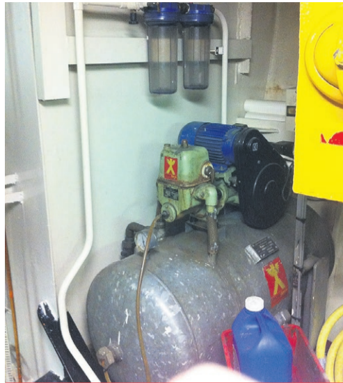
Situatie voor: hydrofoor met opslagtank. Hier is sprake van een verhoogd risico voor legionella.
